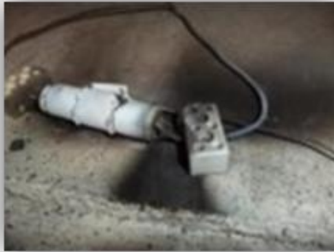
Celda sometida a alta temperatura
